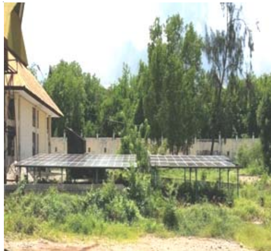
Gambar 1. PV array di Politeknik Negeri Kupang
