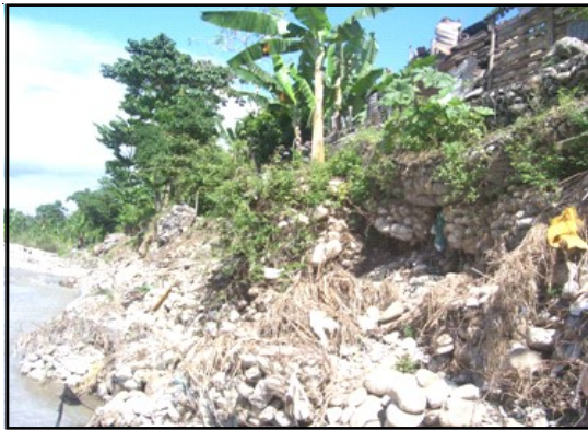
Gambar 7. Tingkat Kerusakan yang sangat berat akibat terjadinya longsor pada Kali Dendeng di Kelurahan Fonte in
