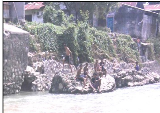
Gambar 6. Tingkat Kerusakan yang sangat berat akibat terjadinya longsoran pada Kali Dendeng di Kelurahan Fontein
