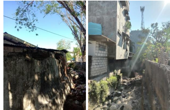
Gambar 8 Kondisi Drainase yang Dekat dengan Pemukiman
