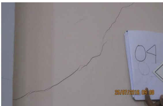
Gambar 3. Retakan di bidang dinding
