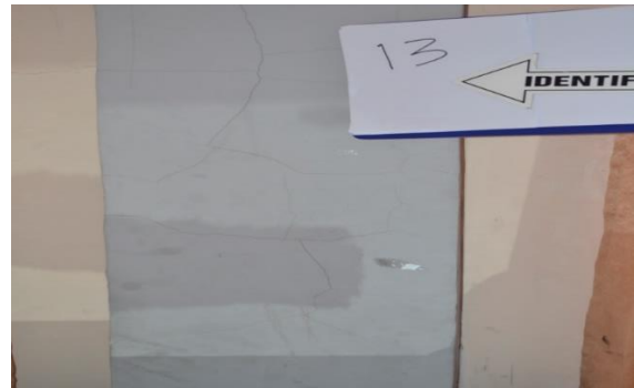
Gambar 4. Retakan di bagian kolom struktur
